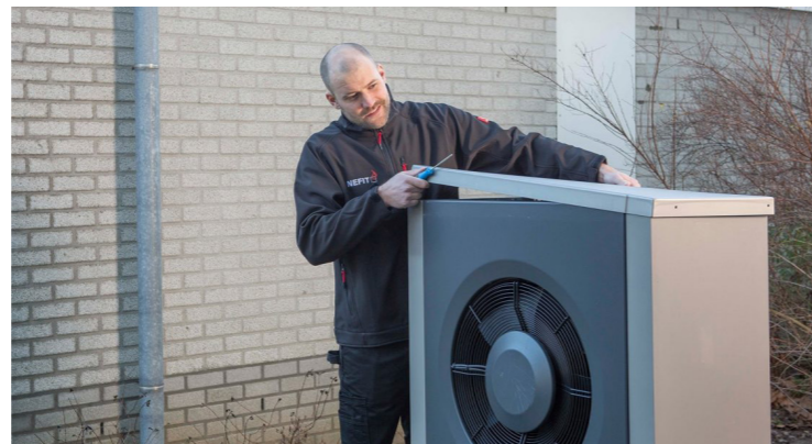
Foto: Nefit Bosch - Installatie warmtepomp
